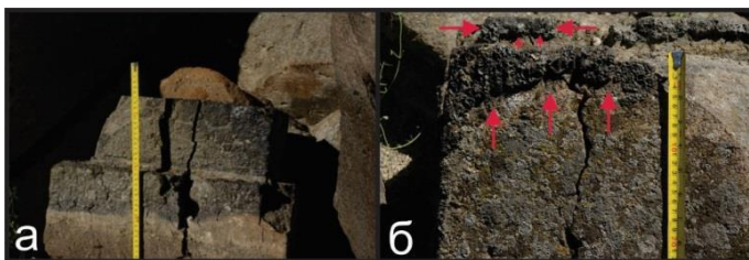
Рис. 5. а) зоны термической закалки на базах колон; б) пузырение расплавленного туфа.
