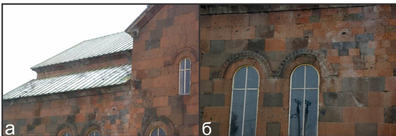
Рис.3.7. а. укрупненный фрагмент переувлажненного верхнего участка восточной стороны северной стен б. находящиеся по соседству (на восточной стороне северной стены) – старые и новые эродированные туфовые блоки.
